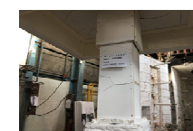
↑柱加熱試験後
