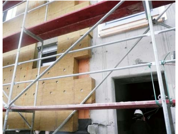
構造体であるCLTの外壁に取り付けられた断熱材
