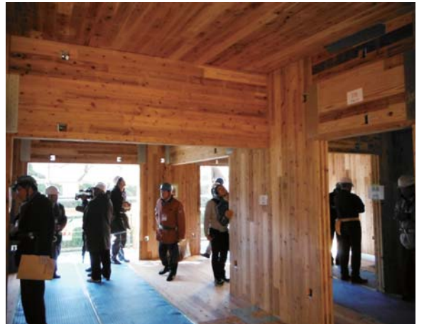
建物内部。重厚な床と引きボルトの大きな座金が印象的
