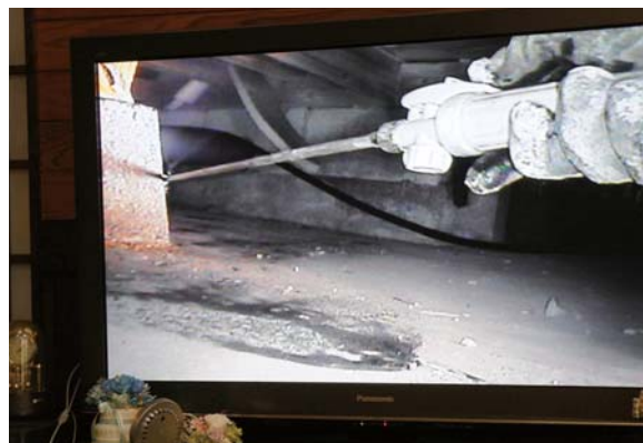
床下での塗布施工の様子を室内のテレビに中継しました
